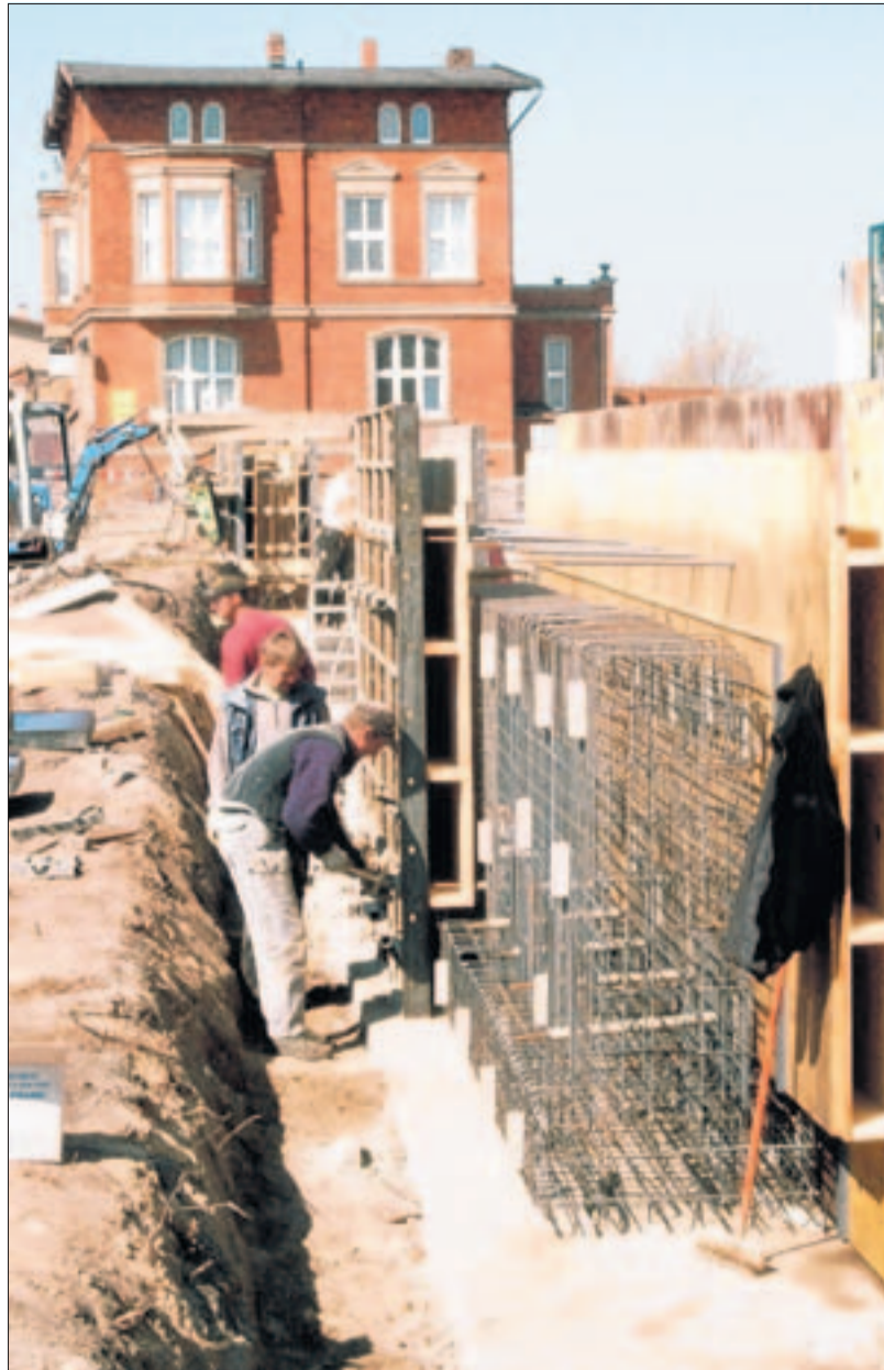
Für die Sturmflutschutzmauer werden von den Arbeitern im Barther Hafen die ersten Schalwände gesetzt. Foto: C. Haiplick
